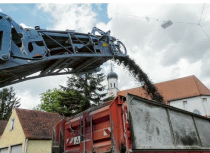
Die Bauarbeiten an der nördlichen Ortsdurchfahrt von Bobingen dauern länger als erwartet. Das Ende ist nun für den 1. September angekündigt. Foto: Kart Rosengart
